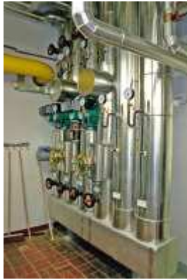
Die neue Heizzentrale einer Hamburger...
