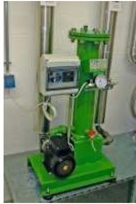
Eine aufgebaute Filteranlage mit Schwingelementen...
